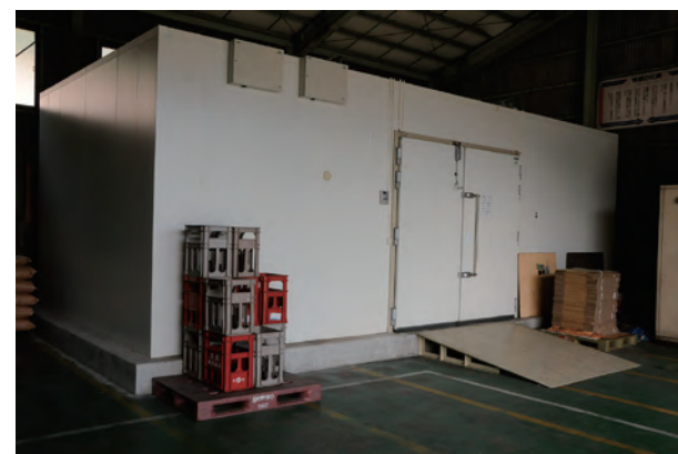
新たな設備を導入した超低温貯蔵庫
