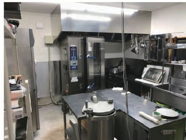
安心・安全を考慮し、新たに設けられた作業場と調理機器
