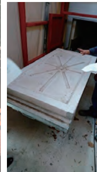
ペット火葬炉の内部。炉床の中央に残脂が流れ込み、下で回収できるようになっている。火葬時間が1時間短縮され、30分ほどで火葬できるようになった
