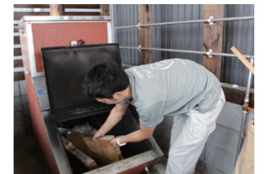
端材を燃やしてお湯を沸かすことで乾燥室内の温度を上げる薪ボイラーお湯循環システム
