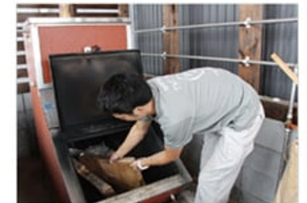
端材を燃やしてお湯を沸かすことで乾燥室内の温度を上げる薪ボイラーお湯循環システム
